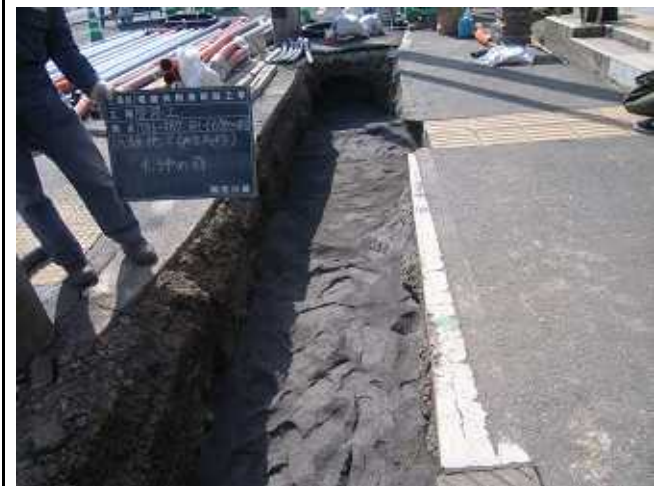
北大路下鴨電線共同溝
